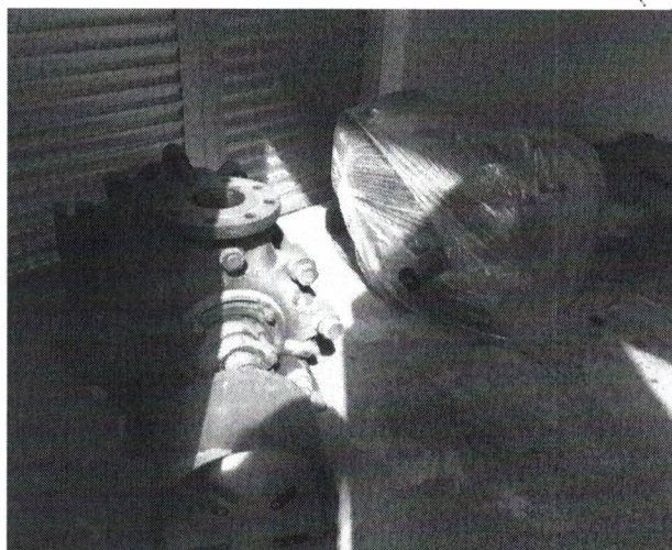
Figura 17: Conjunto motobomba reserva
