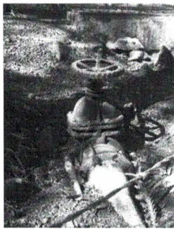
Foto 21 - Vazamento nas conexões
