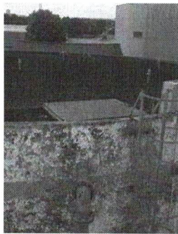
Foto 113 - Tampa da abertura de inspeção
