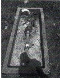
Foto 11 - Instalações hidráulicas do poço
