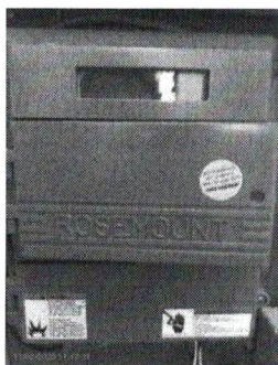
Foto 67 - Conversor de macromedidor (67,95 L/s)
