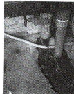
Foto 89 - Vazamento nas conexões
