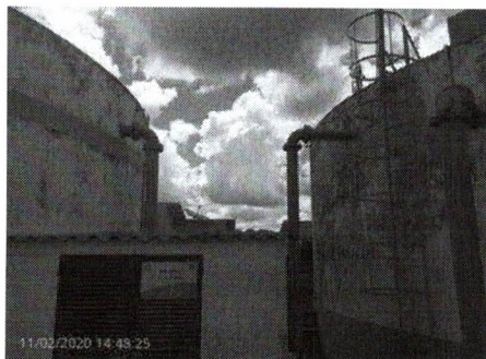
Foto 114 - Extravasores dos reservatórios R1 e R1-A
