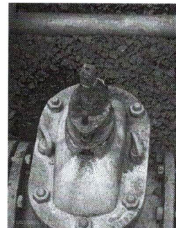
Foto 112 - Vazamento nas instalações
