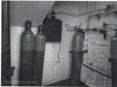
Foto 48 - Sistema de cloro gás
