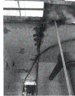
Foto 39 - Estrutura civil com infiltrações
