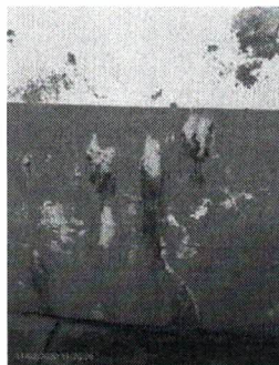
Foto 42 - Eflorescências na estrutura da ETA
