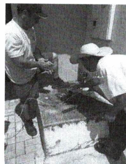
Foto 96 - Ponto de medição de pressão
