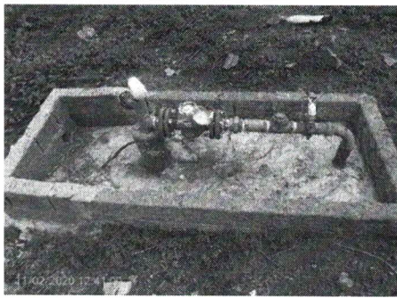
Foto 16 - Instalações sem pintura
