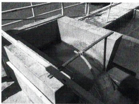
Foto 28 - Entrada de água bruta e adição de PAC
