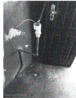
Foto 47 - Dosador de flúor
