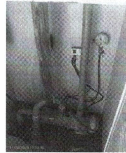
Foto 85 - Ancoragem da bomba realizada de maneira inadequada
