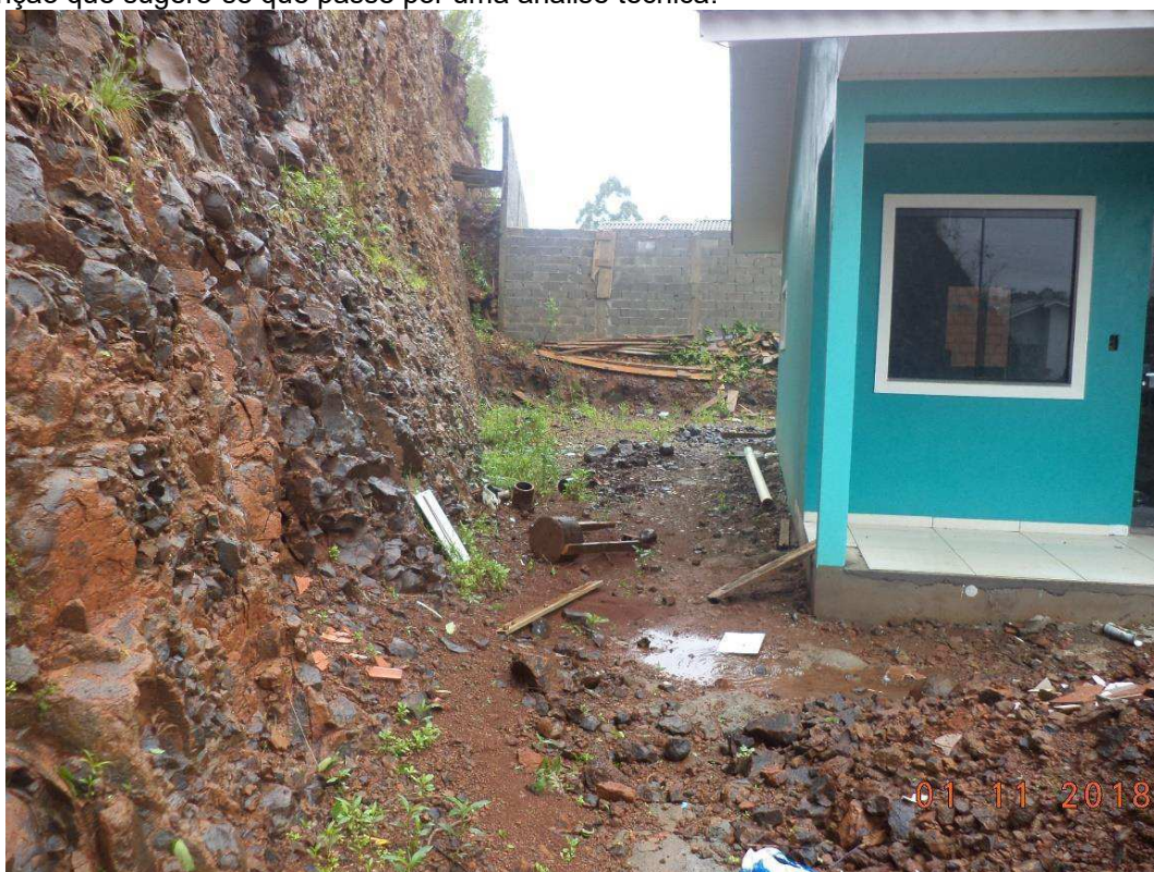
Figura 60: Casa localizada a aproximadamente 2,5 metros do corte. Ao fundo da imagem, o muro de contenção que sugere-se que passe por uma análise técnica.
