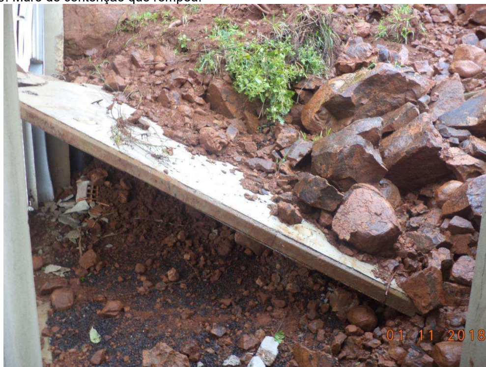
Figura 59: Muro de contenção que rompeu.
